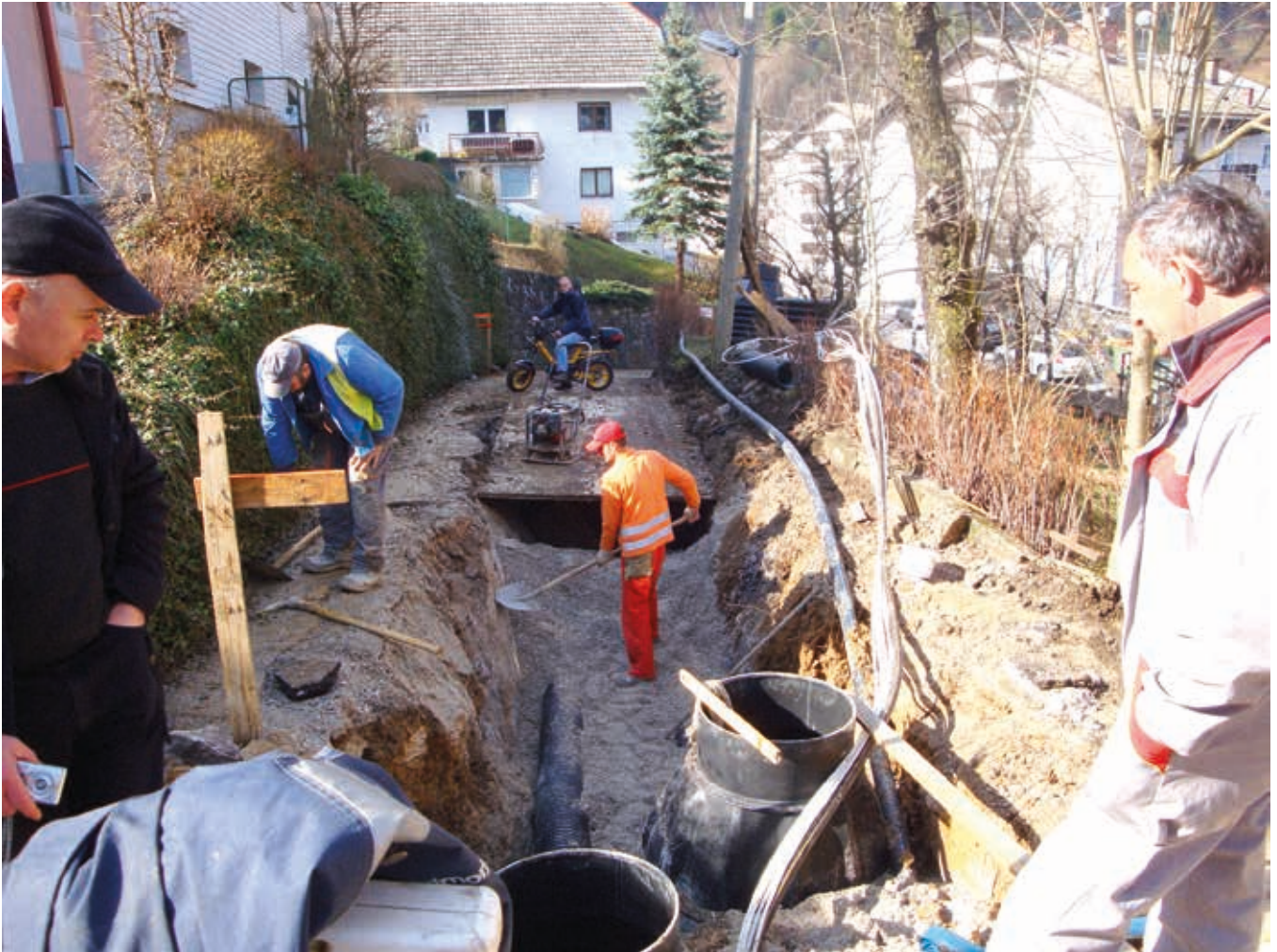
Ob obnovi kanalizacijskega omrežja je bila v izkope vgrajena vsa infrastruktura, tudi optika
