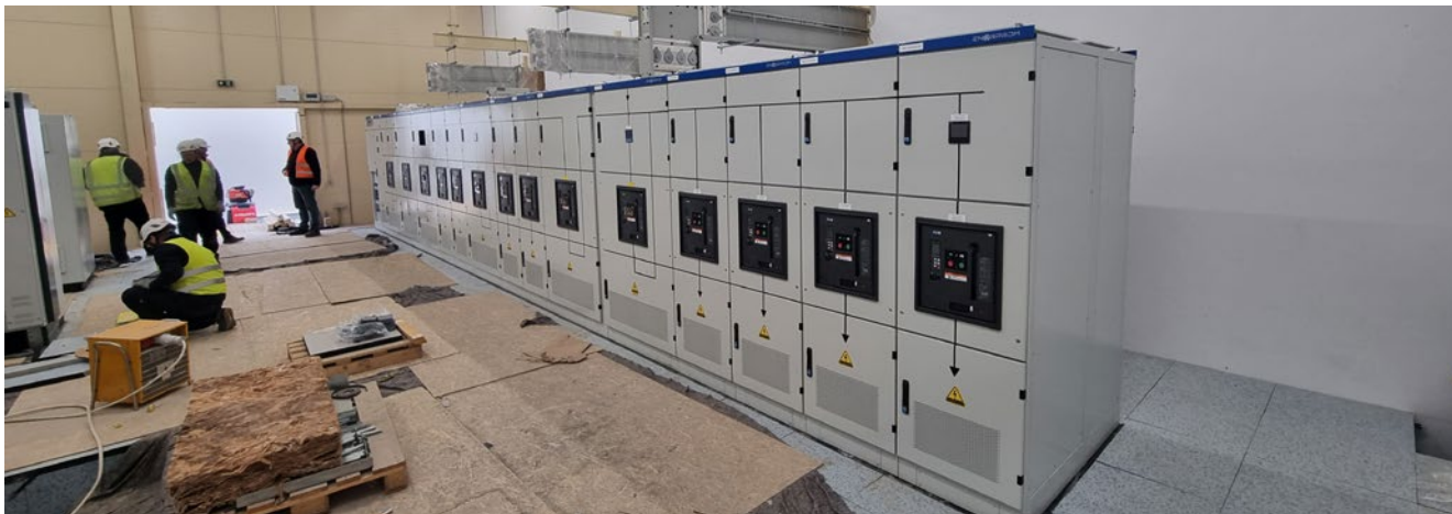
Slika 4: Postavitev, sestavljanje in priključitev osrednjega NN stikalnega bloka xEnergy
