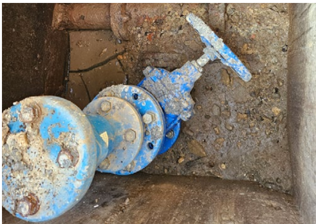
Slika 6: Primer nepravilno vgrajenega odzračevalno/dozračevalnega ventila
