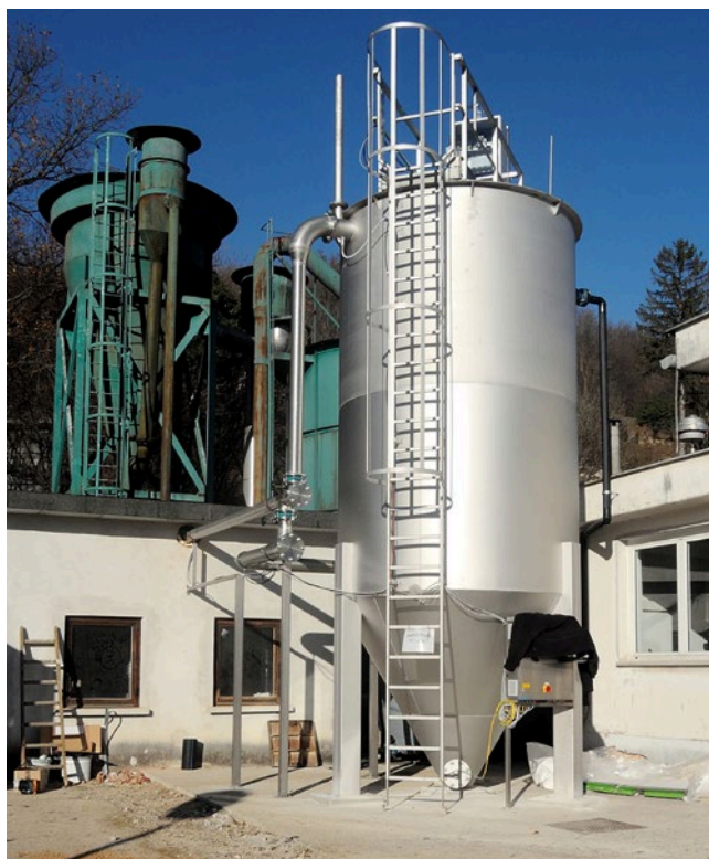
Slika 1: Kontinuirani peščeni filter kot nadomestilo starega gravitacijskega filtra
